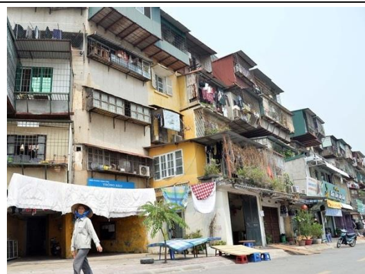
Tòa nhà G6A Thành Công (Ba Đình, Hà Nội) với mức độ nguy hiểm loại D
